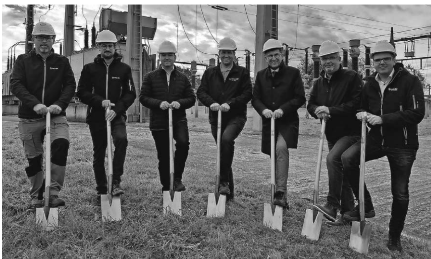
Das Umspannwerk im Hesselbühl wird umfassend erneuert. Neben Bürgermeister Ralph Gerster und Jörg-Arne Bias, Andreas Spieß und Manuel Dipfel von der Regionalnetze Linzgau griffen Rainer Sauter, Marco Friedel und Thomas Herkommer von der Netze BW beim Baustart zum Spaten.
